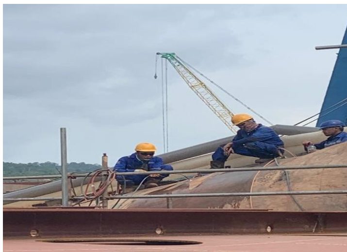
Gambar 2.32 cara menanggulangi dan memperbaiki plat yang terjadi deformasi
