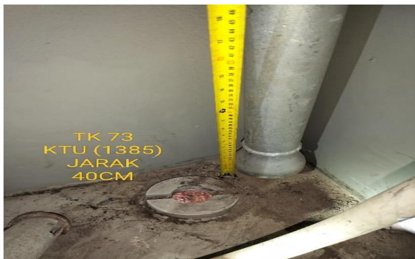
Gambar 2.24 Melakukan general house keeping dan dilanjutkan pengukuran dan pengecekan jarak pemasangan pipe sounding kapal gearless
