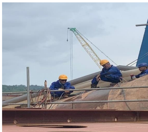
Gambar 2.32 Cara menanggulangi dan memperbaiki Plat yang terjadi Deformasi .
