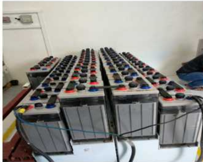
Gambar 4.3 Perawatan Baterai Starting (Sumber : Dokumentasi Kerja Praktek)
