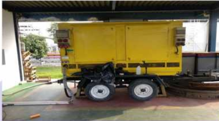
Gambar 4.1 Mesin Emergency Diesel Generator (Sumber : Dokumentasi Kerja Praktek)
