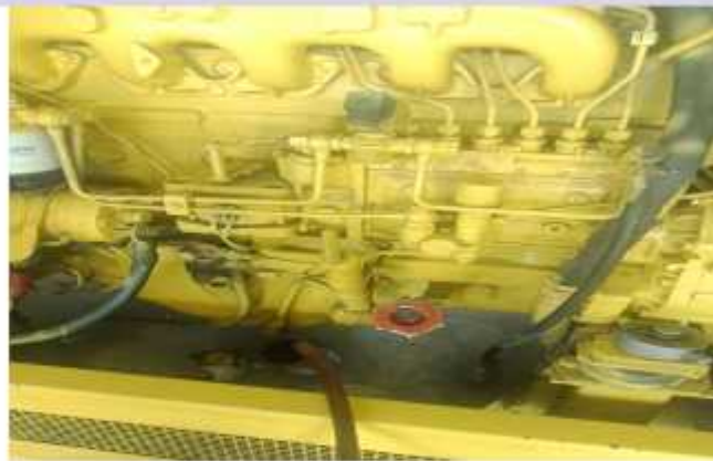
Gambar 4.2 Perawatan Pada Mesin Diesel Dibagian Bahan Bakar (Sumber : Dokumentasi Kerja Praktek)
