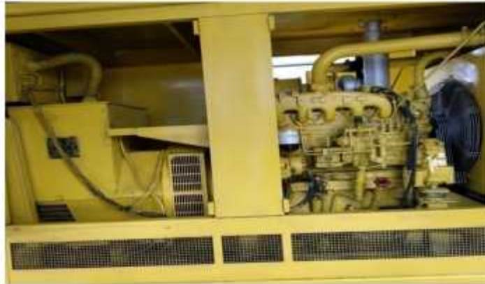
Gambar 4.4 Pemanasan Genset (Sumber : Dokumentasi Kerja Praktek)
