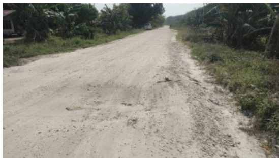
Gambar 1.1 Kondisi Jalan Soebrantas, Rupert (sumber : Dokumentasi lapangan)
