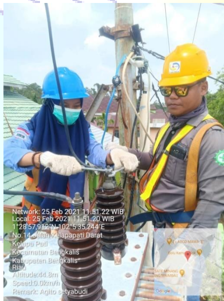
Gambar 2. 6 Perawatan PHB-TR (Perangkat Hubung Bagi Tegangan Rendah) (Sumber : Dokumentasi.2021)
