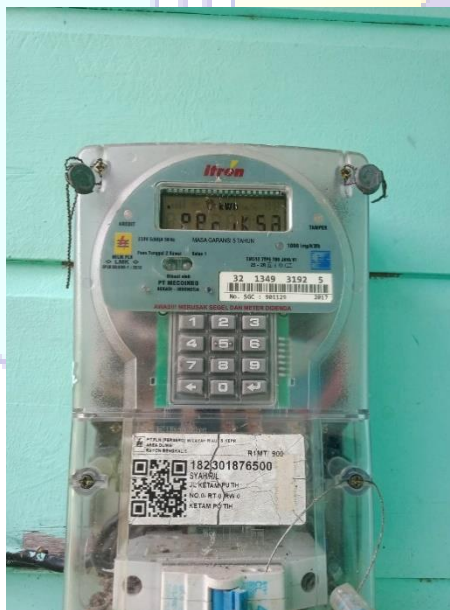
Gambar 2. 10 Gangguan kWh meter periksa (Sumber : Dokumentasi.2021)
