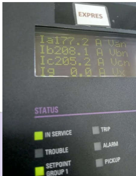
Gambar 2. 43 Eviden beban feeder (Sumber : Dokumentasi.2021)
