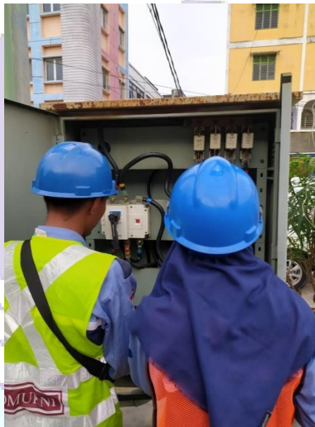
Gambar 2. 25 Penyeimbangan beban trafo (Sumber : Dokumentasi.2021)
