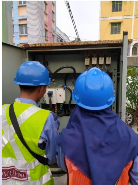
Gambar 2. 16 Penyeimbangan beban trafo (Sumber : Dokumentasi.2021)
