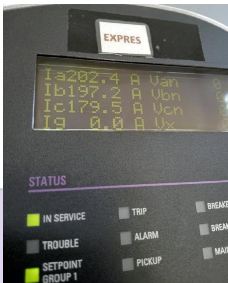
Gambar 2. 37 Eviden beban feeder (Sumber : Dokumentasi.2021)
