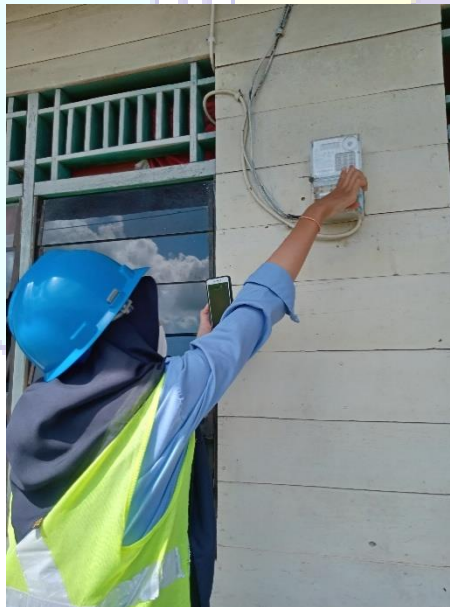
Gambar 2. 17 Mengatasi gangguan kWh meter periksa (Sumber : Dokumentasi.2021)
