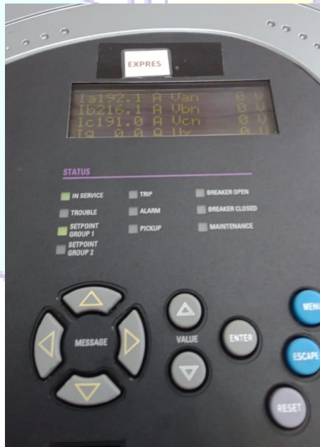
Gambar 2. 5 Eviden beban feeder (Sumber : Dokumentasi.2021)
