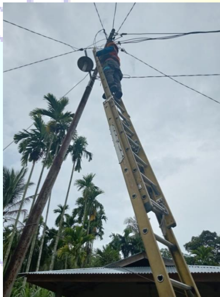
Gambar 3. 5 Gangguan lost kontak nol 5 rumah padam (Sumber : Dokumentasi.2021)
