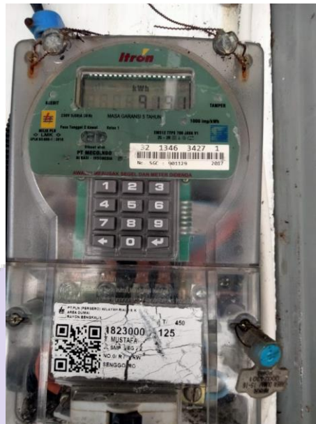
Gambar 2. 26 Gangguan kWh meter periksa (Sumber : Dokumentasi.2021)
