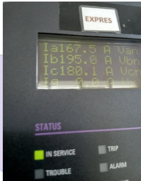
Gambar 2. 40 Eviden beban feeder (Sumber : Dokumentasi.2021)
