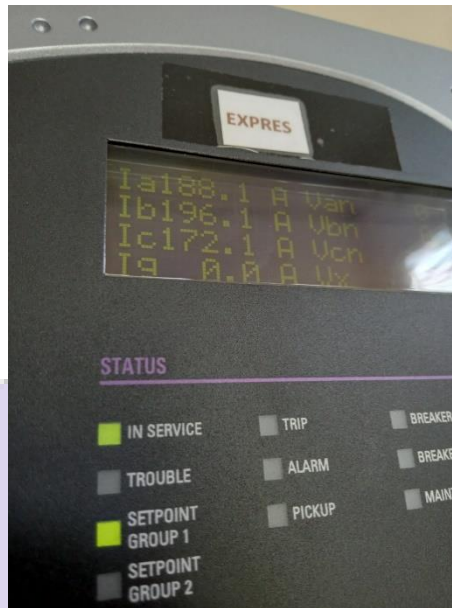
Gambar 2. 47 Eviden beban feeder (Sumber : Dokumentasi.2021)
