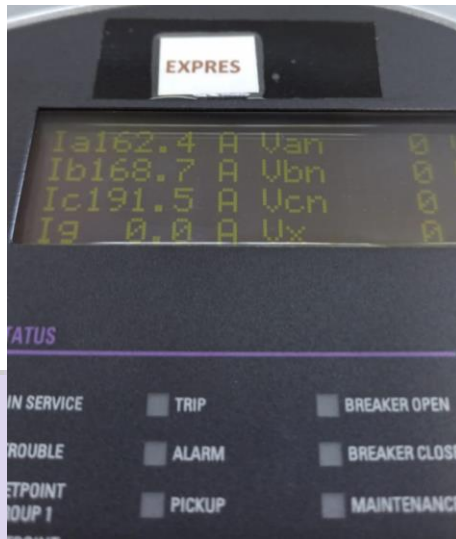
Gambar 2. 32 Eviden beban feeder (Sumber : Dokumentasi.2021)
