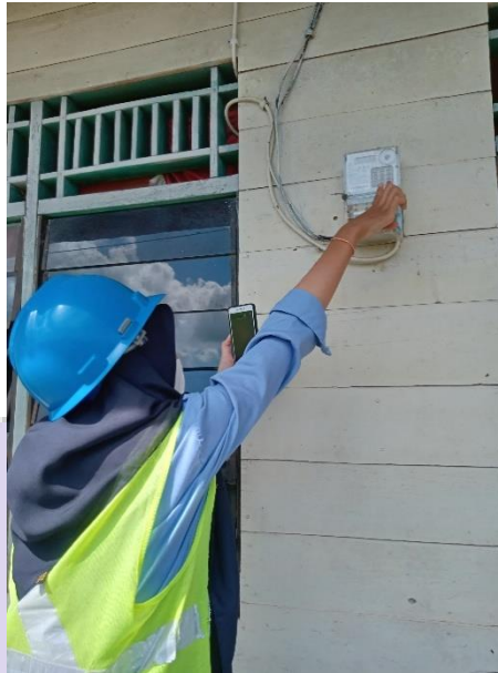
Gambar 2. 21 Mengatasi kWh meter periksa (Sumber : Dokumentasi.2021)
