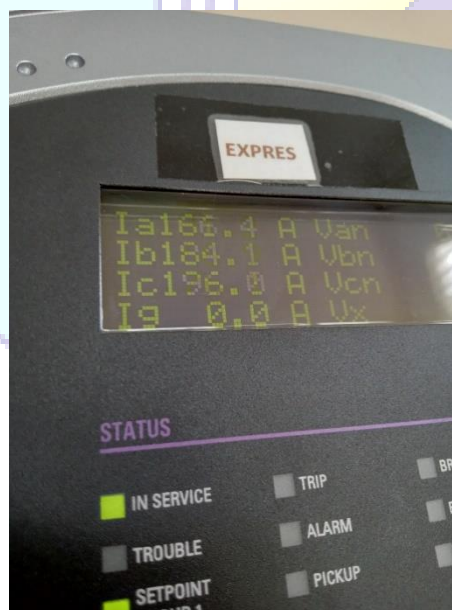
Gambar 2. 53 Eviden beban feeder (Sumber : Dokumentasi.2021)
