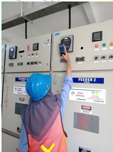
Gambar 2. 22 Eviden beban feeder (Sumber : Dokumentasi.2021)
