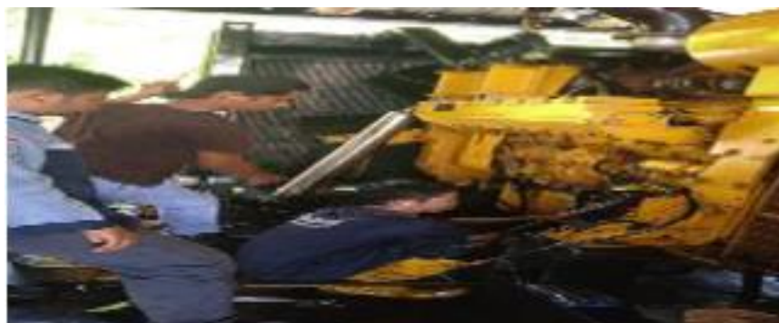
Gambar 2.24 maintanece mesin rusak ( Sumber : PT.MEGAPOWER MAKMUR Tbk.2021)
