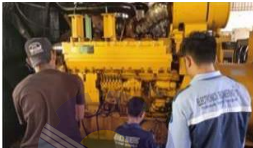
Gambar 2.23 maintanece mesin rusak ( Sumber : PT.MEGAPOWER MAKMUR Tbk.2021)
