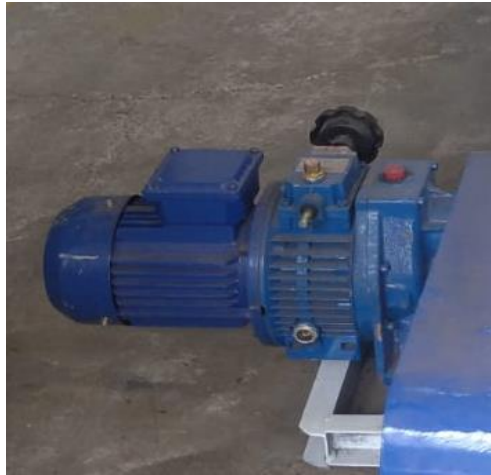
Gambar 3.5. Motor Listrik 3 Fasa Sumber : Dokumentasi Pribadi di PT. Cassia Co-op
