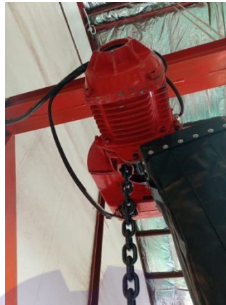
Gambar 3.5. Motor penggerak dan Puli ( Lift Barang )
