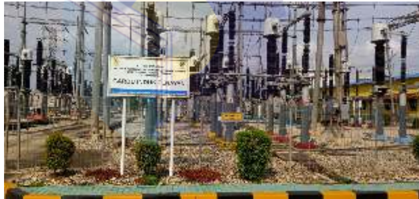
Gambar 1. 1. Gardu Induk PLTU Tenayan
