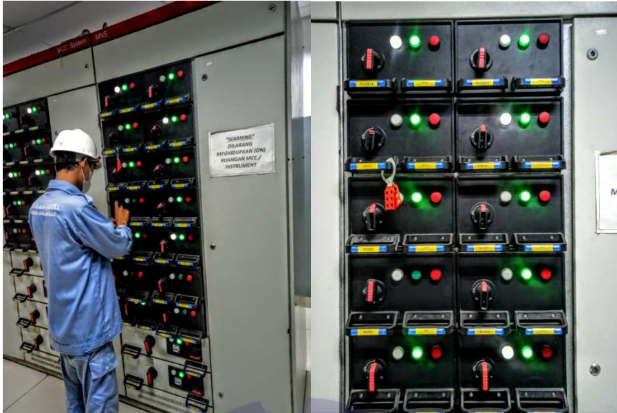
Gambar 2.8 Panel Mcc (Sumber: Dokumentasi Penulis, 2021)
