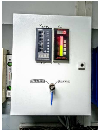
Gambar 3.3 Panel Sistem Control Boiler (Sumber: Dokumentasi Penulis, 2021)
