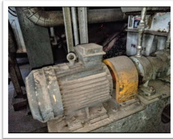
Gambar 3.4 Kawasan Motor Boiler (Sumber: Dokumentasi Penulis, 2021)
