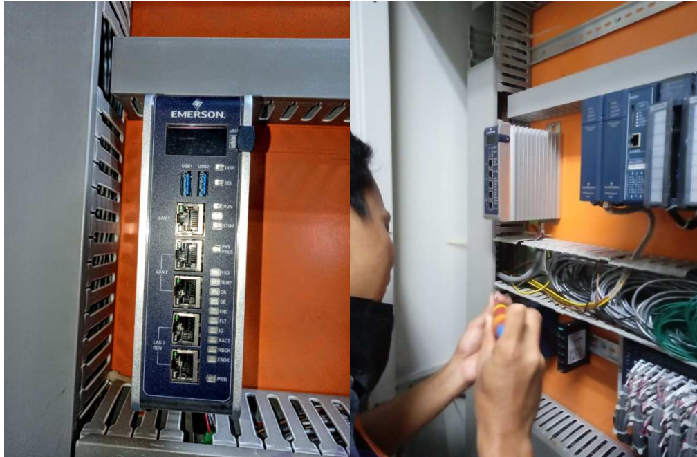
Gambar 2.4 Panel Instrument (Sumber: Dokumentasi Penulis, 2021)
