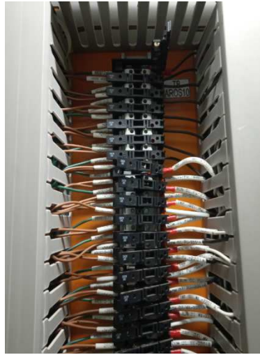
Gambar 2.2 Panel Plc (Sumber: Dokumentasi Penulis, 2021)
