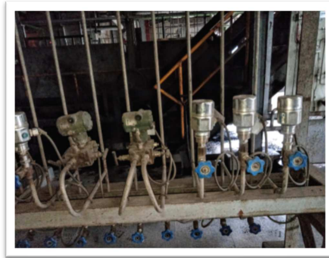
Gambar 3.5 Kawasan Transmitter Boiler (Sumber: Dokumentasi Penulis, 2021)
