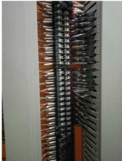
Gambar 2.6 Panel Etp Instrument Plc (Sumber: Dokumentasi Penulis, 2021)
