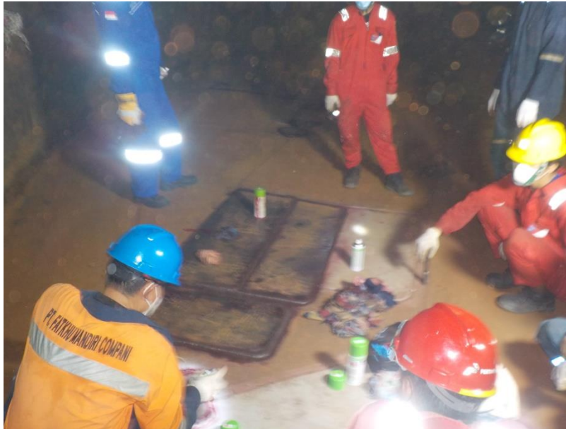
Gambar 5. Uji Fenetran (Fenetran Test) /Cacat Las Sumber : (Dokumen Praktikan)
