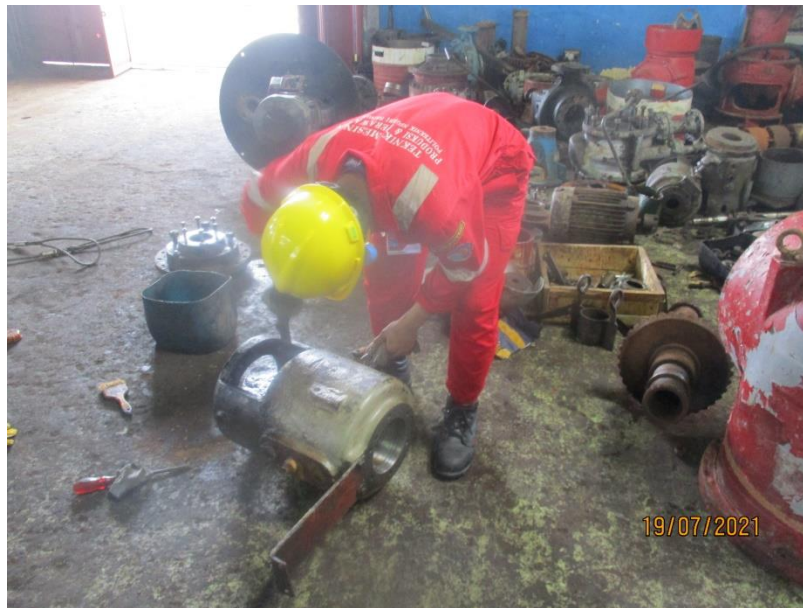
Gambar 3. Membersihkan Case Pump (Sump Pump) Sumber : (Dokumen Praktikan)
