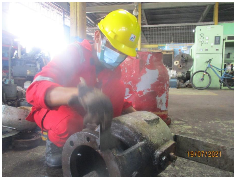
Gambar 4. Membersihkan Case Pump (Sump Pump) Sumber : (Dokumen Praktikan)
