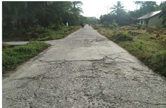
Gambar 1.1 Kondisi eksisting jalan beton Jenderal Sudirman (Sumber : Dokumentasi Lapangan)
