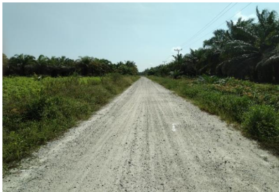
Gambar 1.2 Kondisi eksisting base jalan Jenderal Sudirman (Sumber : Dokumentasi Lapangan)
