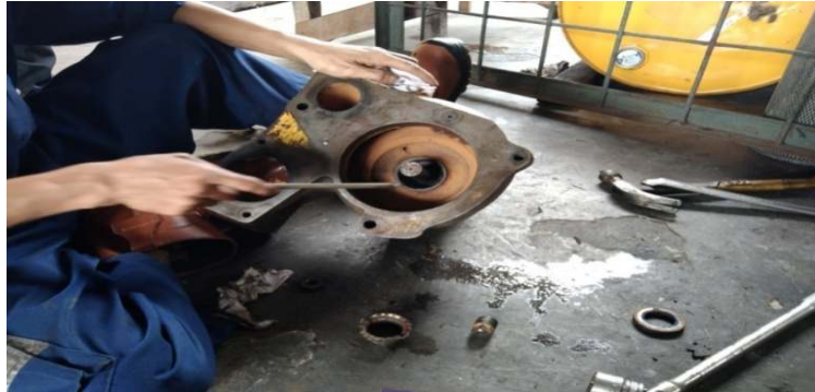
Gambar 4.4 Karatan Pada Dinding Water Pump Sumber: Dokumentasi
