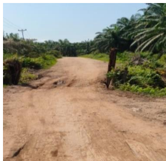
Gambar 1.1. Kondisi eksisting jalan Tanjung Kapal – Darul Aman
