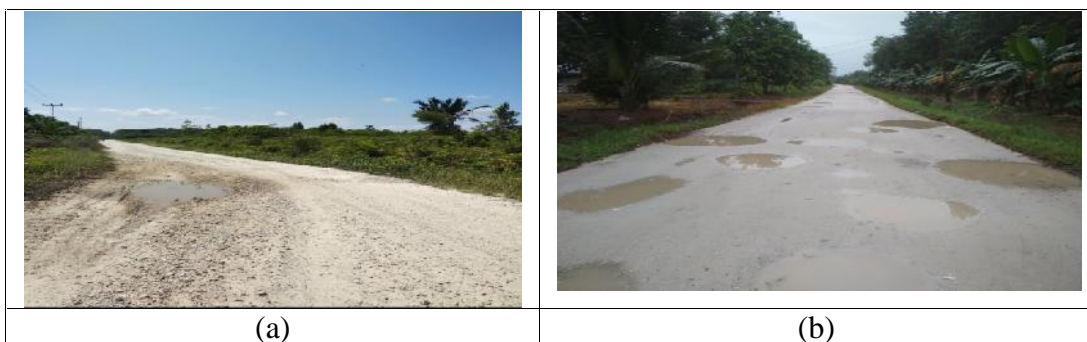
Gambar 1.1 kondisi Jalan Jenderal sudirman menuju jalan Pahlawan (a) Sta 4+700, (b) Sta 5+100.
