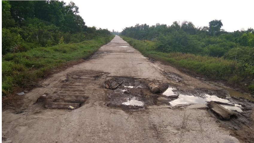
Gambar 1.1 Kondisi jalan Selatbaru – Pambang, STA 34+650
