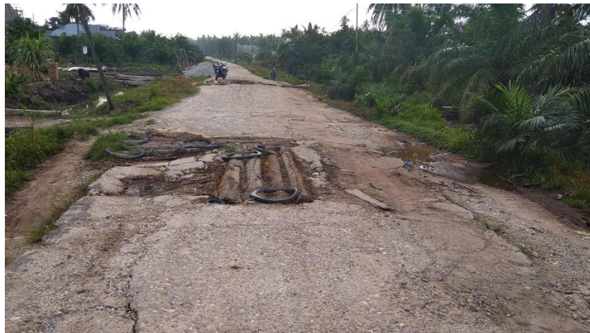
Gambar 1.2 Kondisi jalan Selatbaru – Pambang, STA 35+350
