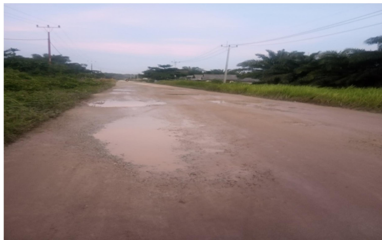
Gambar 1.2 Jalan Jendral Sudirman Di Saat Musim Hujan pada km 9,1 Sumber: Dokumentasi lapangan, 2020
