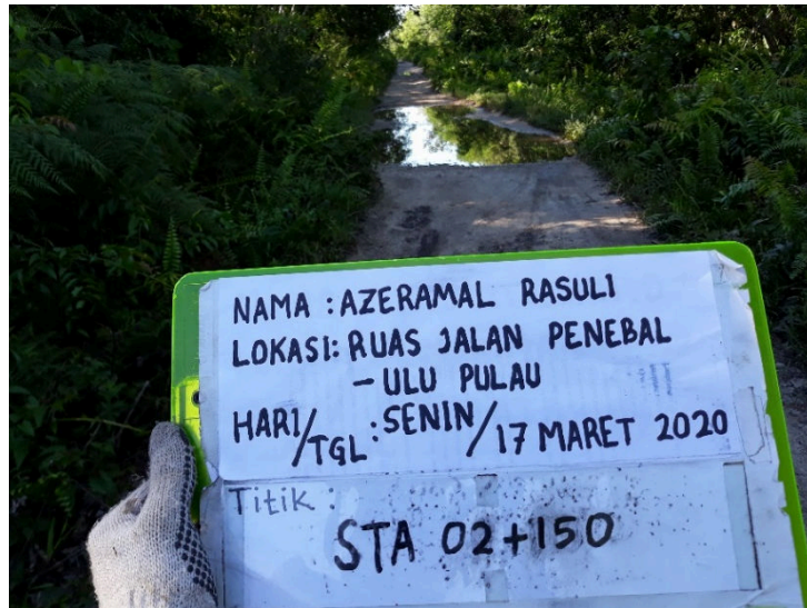
Gambar 1.1 : Kerusakan Pada Ruas Jalan Penebal – Ulu Pulau (Sumber : Dokumentasi Lapangan).
