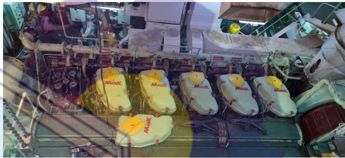
Gambar 2.11 Kamar Mesin KMP Tidar
