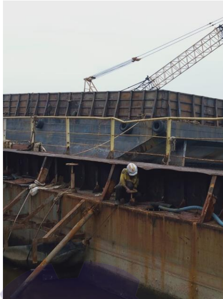
Gambar 2.8 Proses Pembukaan Valve Tangki Pintu Dock
