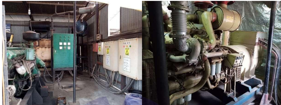
Gambar 1.5 .Genset 760 kVA dan Genset 260 kVA PT. Yasa Wahana Tirta Samudera
