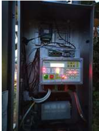
Gambar 2. 14 Penormalan RC Trip (Sumber :PLN. Rayon bengkalis PT. Adra gemilang.2021)
