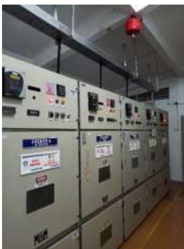
Gambar 2. 6 Pengecekan beban feeder (Sumber :PLN. Rayon bengkalis PT. Adra gemilang.2021)
