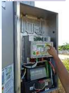
Gambar 2. 27 Penormalan RC Trip (Sumber :PLN. Rayon bengkalis PT. Adra gemilang.2021)
