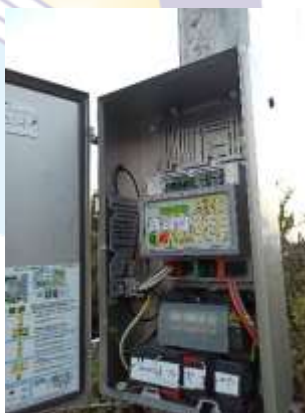
Gambar 2. 7 Penormalan RC Trip (Sumber :PLN. Rayon bengkalis PT. Adra gemilang.2021)
