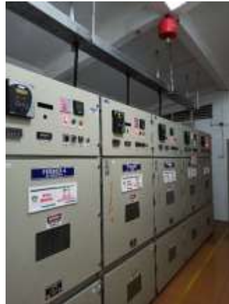
Gambar 2. 10 Pengecekan rutin beban feeder (Sumber :PLN. Rayon bengkalis PT. Adra gemilang.2021)
