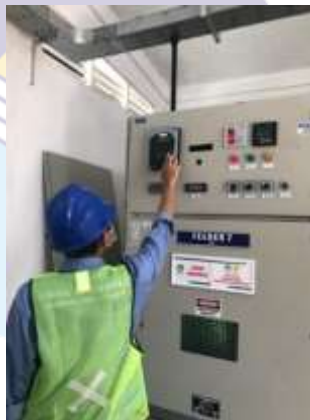
Gambar 2. 3 Pengecekan beban feeder (Sumber :PLN. Rayon bengkalis PT. Adra gemilang.2021)
