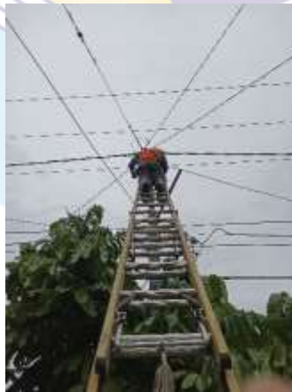
Gambar 2. 33 loss kontak (Sumber :PLN. Rayon bengkalis PT. Adra gemilang.2021)
