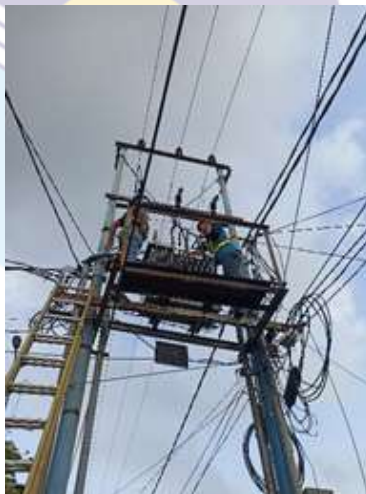
Gambar 2. 21 Pemeliharaan PHBTR Trafo (Sumber :PLN. Rayon bengkalis PT. Adra gemilang.2021)
