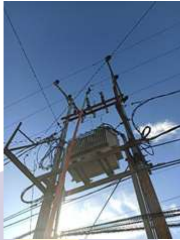
Gambar 2. 30 Penggantian fuse link yang terbakar (Sumber :PLN. Rayon bengkalis PT. Adra gemilang.2021)
