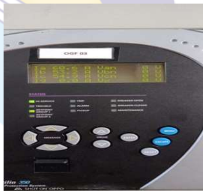
Gambar 2. 11 Pengecekan rutin beban feeder (Sumber :PLN. Rayon bengkalis PT. Adra gemilang.2021)
