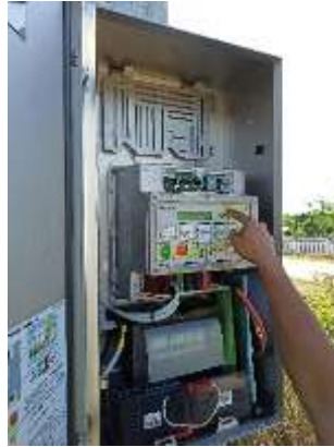
Gambar 2. 12 Penormalan RC Trip (Sumber :PLN. Rayon bengkalis PT. Adra gemilang.2021)
