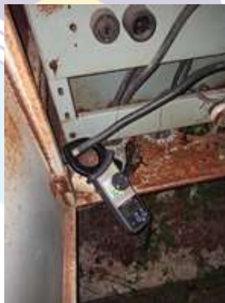
Gambar 2. 19 Pengecekan arus dan tegangan (Sumber :PLN. Rayon bengkalis PT. Adra gemilang.2021)
