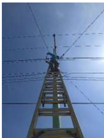
Gambar 2. 34 loss kontak (Sumber :PLN. Rayon bengkalis PT. Adra gemilang.2021)
