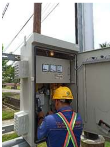
Gambar 2. 24 Inspeksi dan pengukuran gardu (Sumber :PLN. Rayon bengkalis PT. Adra gemilang.2021)
