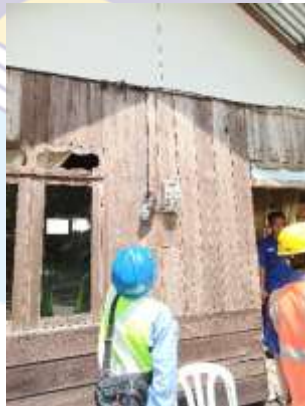
Gambar 2. 9 KWH Meter boros (Sumber :PLN. Rayon bengkalis PT. Adra gemilang.2021)
