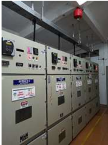
Gambar 2. 36 Beban penyulang (Sumber :PLN. Rayon bengkalis PT. Adra gemilang.2021)
