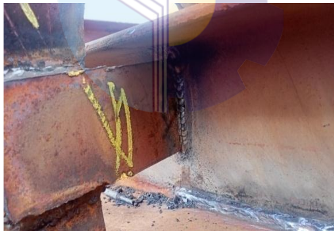
Gambar 2. 34 Miss welding dan crack
