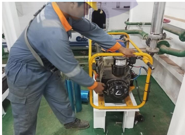
Gambar 2. 27 Proses menghidupkan mesin emergency hydrant
