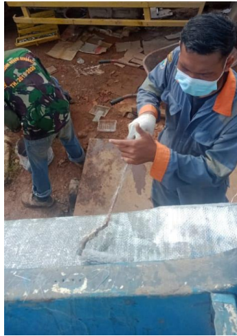
Gambar 2.14 Laminasi Pada Bagian Yang Rusak
