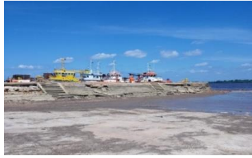
Gambar 2.32 Inspeksi kerusakan Slipway kolam 2
