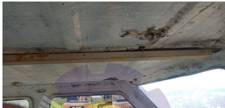
Gambar 2.17 Kondisi baja ringan yang terpasang
