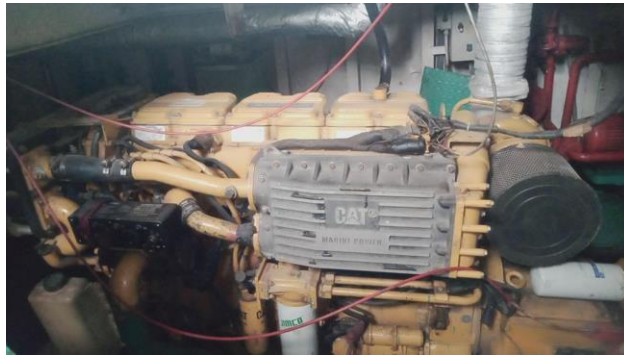
Gambar 2.7 Ruang kamar mesin
