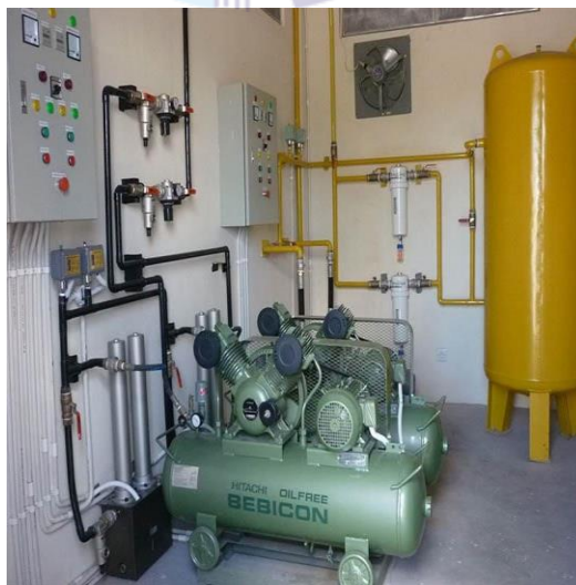
Gambar 2. 14 Compressor pada kapal crane barge
