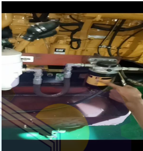
Gambar 2. 45 Pengecekan filter oil pada generator
