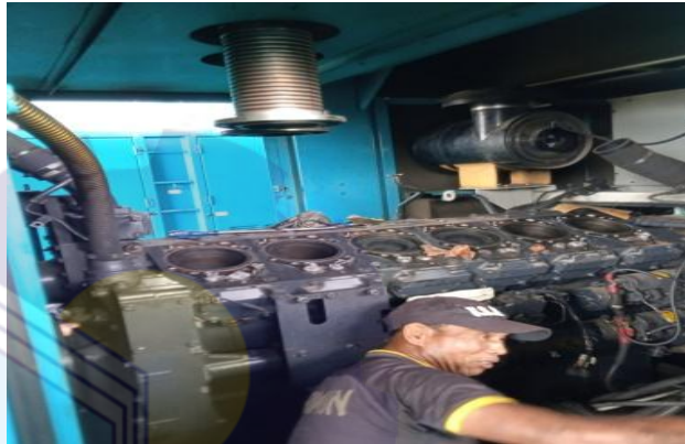
Gambar 2.2 Mesin Generator Listrik
