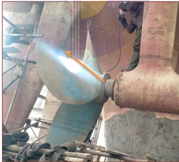
Gambar 3.2. Kondisi propeller sebelah kanan
