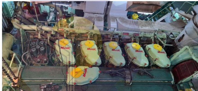
Gambar 2.11 Kamar Mesin KMP Tidar
