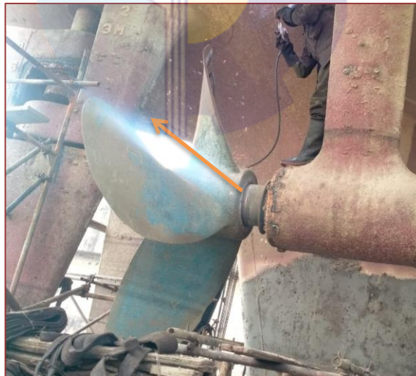
Gambar 3.2. Kondisi propeller sebelah kanan
