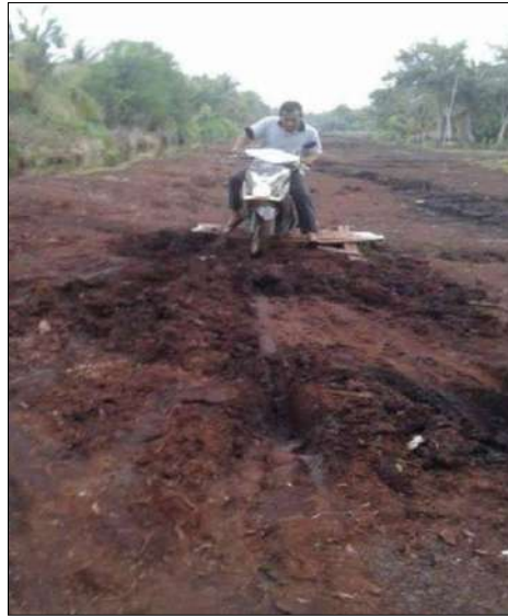
Gambar 1.1 Gambar Jalan Parit Tugu Sebelum Peningkatan
