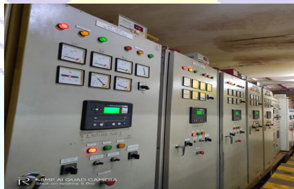
Gambar 3.35 Panel GCP 380 KVA
