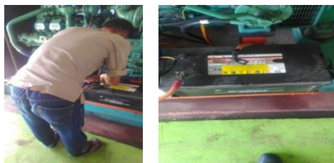
Gambar 3.8 Memperbaiki kepala batrai yang rusak
