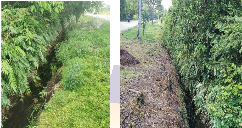
Gambar 1.1 Kondisi Drainase Sumber : Dokumentasi TA 2022
