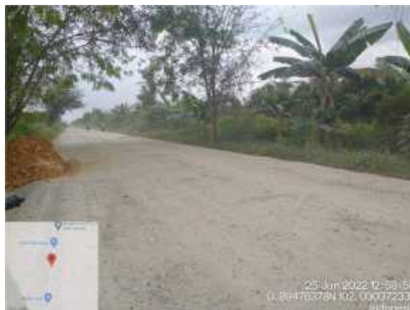
Gambar 1.1 Kondisi Eksisting Jalan Raya Bungaraya - Siak Sumber : Dokumentasi di Lapangan
