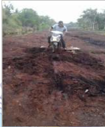
Gambar 1.1 Gambar Jalan Parit Tugu Sebelum Peningkatan
