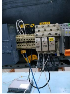
Gambar 2.8 Menghubungkan switch ke CPU dengan output Relay
