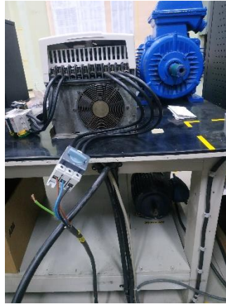
Gambar 2.15 Koneksi VSD ACS-800 ke Motor 3 Fasa
