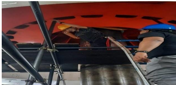
Gambar 2. 47 Maintenance generator unit 2 PLTA (Sumber: Unit Layanan PLTA Koto Panjang. 2022)
