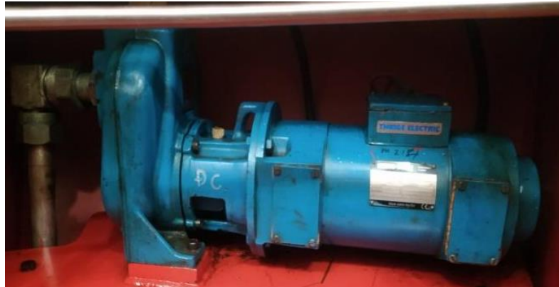
Gambar 3. 9 Motor Listrik DC (Sumber: Unit Layanan PLTA Koto Panjang. 2022)
