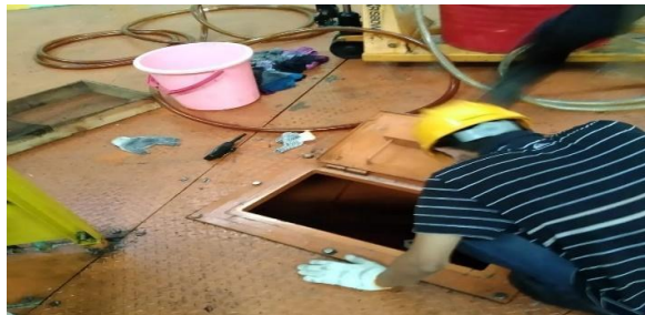
Gambar 2. 15 Pengisian oli area generator (Sumber: Unit Layanan PLTA Koto Panjang. 2022)
