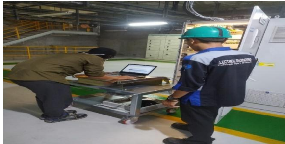
Gambar 2. 7 Monitoring panel eksitasi unit 3 (Sumber: Unit Layanan PLTA Koto Panjang. 2022)
