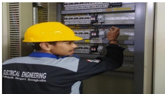
Gambar 2. 32 Monitoring pada panel proteksi (Sumber: Unit Layanan PLTA Koto Panjang. 2022)
