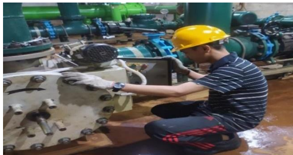
Gambar 2. 54 Maintenance strainer (Sumber: Unit Layanan PLTA Koto Panjang. 2022)
