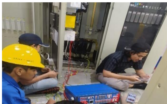
Gambar 2. 52 Maintenance panel hubung bagi rele proteksi (Sumber: Unit Layanan PLTA Koto Panjang. 2022)
