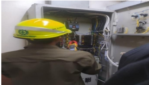
Gambar 2. 31 Monitoring panel surya (Sumber: Unit Layanan PLTA Koto Panjang. 2022)
