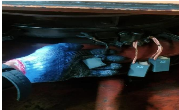
Gambar 2. 56 Maintenance carbon brush (Sumber: Unit Layanan PLTA Koto Panjang. 2022)
