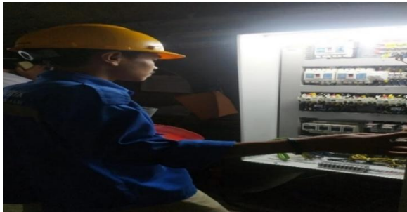
Gambar 2. 18 Monitoring panel kontrol dam galeri (Sumber: Unit Layanan PLTA Koto Panjang. 2022)
