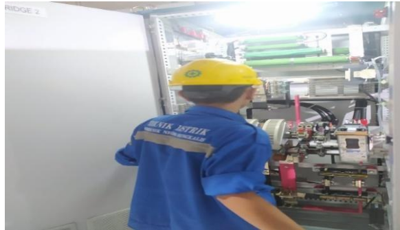
Gambar 2. 51 Panel AVR unit dua PLTA (Sumber: Unit Layanan PLTA Koto Panjang. 2022)
