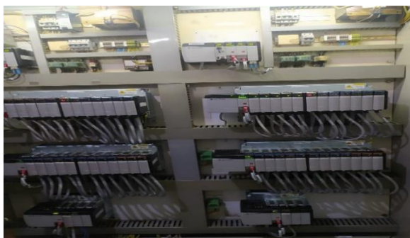
Gambar 2. 33 Preventif pada plc PLTA koto panjang (Sumber: Unit Layanan PLTA Koto Panjang. 2022)
