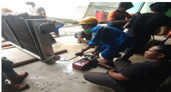
Gambar 2. 55 Maintenance air cooler (Sumber: Unit Layanan PLTA Koto Panjang. 2022)
