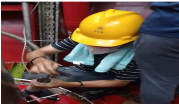
Gambar 2. 58 Maintenance Control level switch (Sumber: Unit Layanan PLTA Koto Panjang. 2022)
