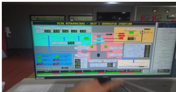
Gambar 2. 13 Ruang kontrol pada PLTA (Sumber: Unit Layanan PLTA Koto Panjang. 2022)
