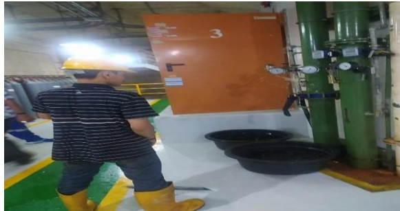
Gambar 2. 2 Maintenance pada Termometer Pipa (Sumber: Unit Layanan PLTA Koto Panjang. 2022)
