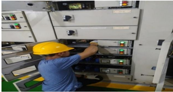
Gambar 2. 47 Maintenance pada panel (Sumber: Unit Layanan PLTA Koto Panjang. 2022)
