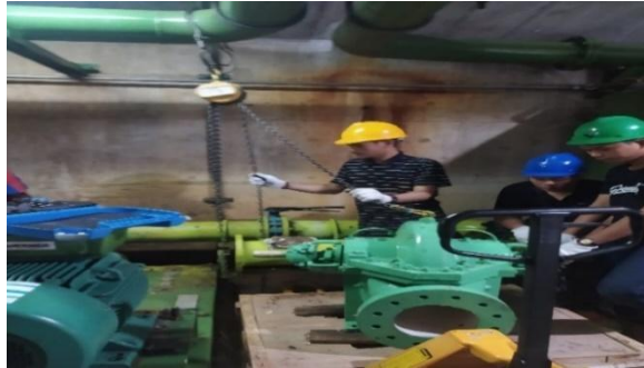
Gambar 2. 49 Pemasangan pompa ke mesin 3 phase (Sumber: Unit Layanan PLTA Koto Panjang. 2022)
