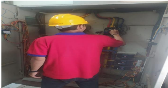
Gambar 2. 28 Pengecekan pada panel lantai 4 PLTA (Sumber: Unit Layanan PLTA Koto Panjang. 2022 )
