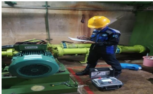
Gambar 2. 45 Pengujian isolasi motor 3 phase ( Sumber : Unit Layanan PLTA Koto Panjang. 2022)
