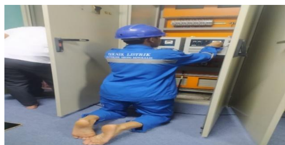
Gambar 2. 53 Maintenance panel eksitasi (Sumber: Unit Layanan PLTA Koto Panjang. 2022)
