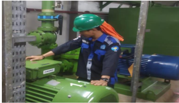
Gambar 2. 17 Monitoring pompa dan motor 3 phase (Sumber: Unit Layanan PLTA Koto Panjang. 2022)
