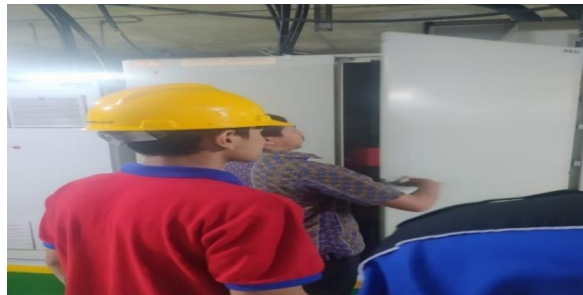
Gambar 2. 29 Pengecekan pada panel unit 2 PLTA (Sumber: Unit Layanan PLTA Koto Panjang. 2022 )
