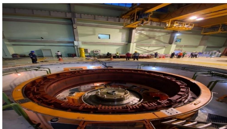
Gambar 3. 4 Stator PLTA Koto panjang (Sumber: Arsip Perusahaan)
