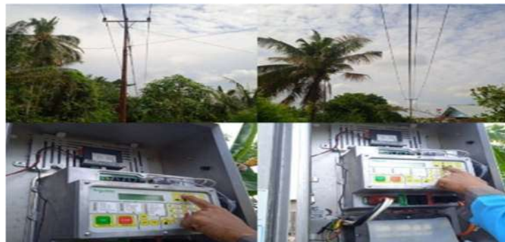
Gambar 2.32. Pengecekan Trip pada LBS (Sumber:PT.PLN ULP Bagan Siapi-Api 2022)
