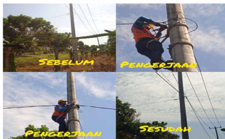
Gambar 2.28. Pemasangan kabel SKU-TR yang lepas (Sumber:PT.PLN ULP Bagan Siapi-Api 2022)
