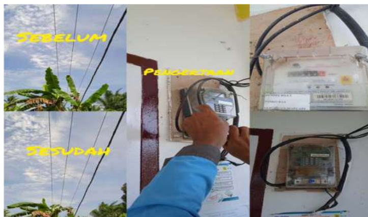
Gambar 2.29. Pemasangan kwh meter dami/ sementara (Sumber: PT. PLN ULP Bagan Siapi-Api 2022)
