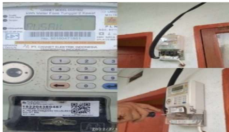
Gambar 2.36. Pemasangan Kwh meter dami/ sementara (Sumber:PT.PLN ULP Bagan Siapi-Api 2022)
