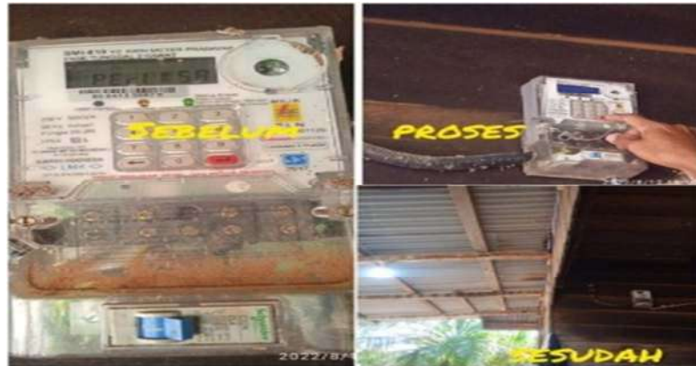
Gambar 2.52. Memperbaiki konektor yang longgar/lost kontak (Sumber:PT.PLN ULP Bagan Siapi-Api 2022)
