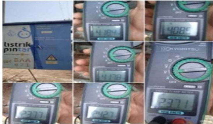
Gambar 2.54. Pengukuran tegangan pada Gardu PHB-TR (Sumber: PT. PLN ULP Bagan Siapi-Api 2022)
