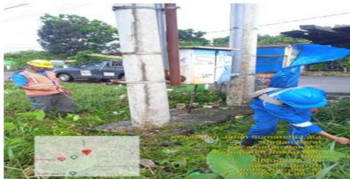
Gambar 2.5. Pemeliharaan PHB(Panel hubung bagi) (Sumber:PT.PLN ULP Bagan Siapi-Api 2022)
