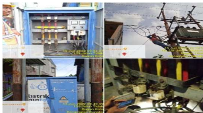
Gambar 2.11. Penimbangan beban Trafo (Sumber:PT.PLN ULP Bagan Siapi-Api 2022)
