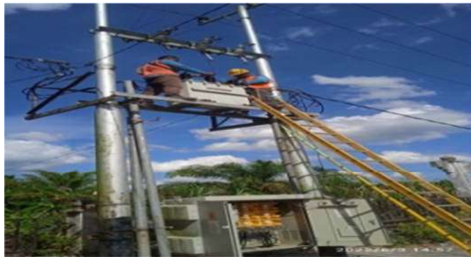
Gambar 2.2. Pemeliharaan PHB-TR (Panel hubung bagi) (Sumber:PT.PLN ULP Bagan Siapi-Api 2022)
