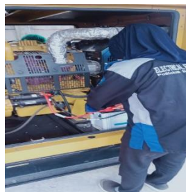
Gambar 2. 16: mesin genset Sumber : Dokumentasi pribadi di PT.Cassia Co-op.
