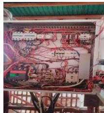
Gambar 2. 9 : panel kontrol Sumber : Dokumentasi pribadi di PT.Cassia Co-op.
