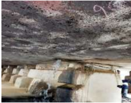
Gambar 2.28 Kebocoran Pada Lambung
