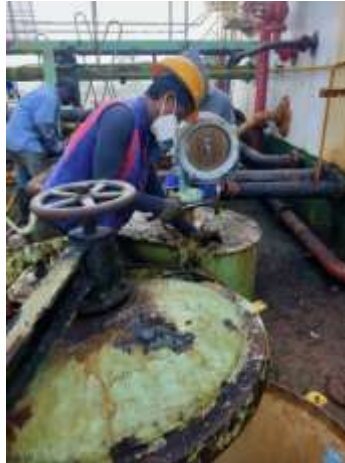
Gambar 2.22 pembersihan Cat dan Korosi
