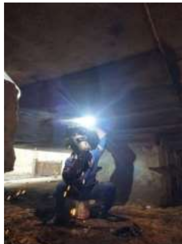
Gambar 2.29 Pengelasan Pada Lambung Yang rusak
