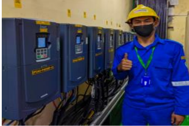
Gambar 2.10 Pengoperasian Inverter GCC Pump (Sumber: Dokumentasi di PT. Indah Kiat Pulp & Paper)
