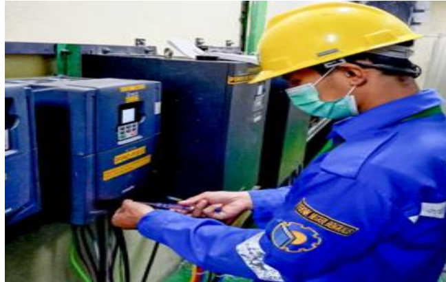
Gambar 2.12 Pengecekan Inverter Motor GCC Pump (Sumber: Dokumentasi di PT. Indah Kiat Pulp & Paper)
