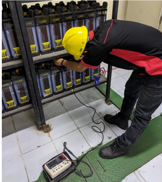
Gambar 2.6 Pengecekan Tegangan Baterai (Sumber: Dokumentasi di PT. Indah Kiat Pulp & Paper)
