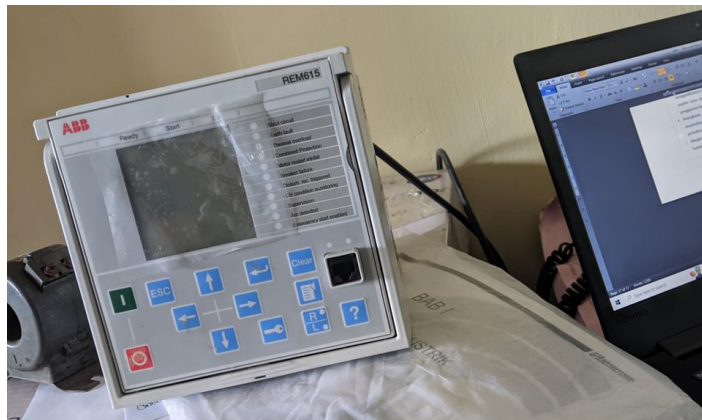
Gambar 2.20 Pengoperasian Relay ABB REM 615 (Sumber: Dokumentasi di PT. Indah Kiat Pulp & Paper)
