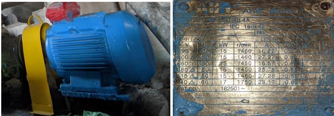
Gambar 3.9 Motor dan Nameplate GCC Pump PT. IKPP (Sumber: Dokumentasi di PT. Indah Kiat Pulp & Paper)
