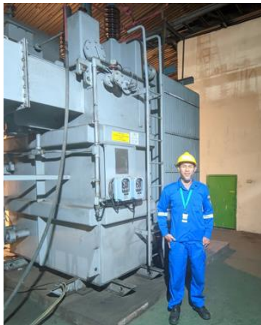
Gambar 2.2 Pengecekan Main Trafo 33 Kv (Sumber: Dokumentasi di PT. Indah Kiat Pulp & Paper)
