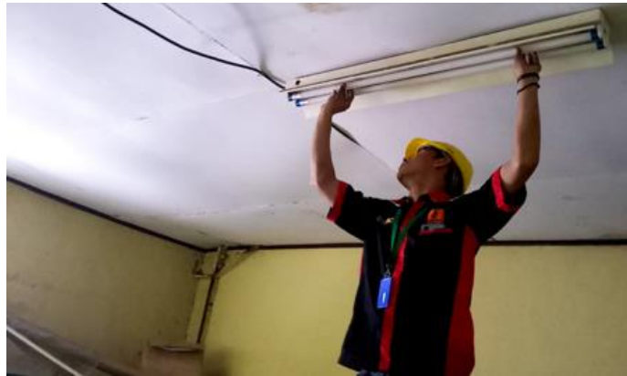
Gambar 2.8 Penggantian Lampu TL Gudang PPM-1 (Sumber: Dokumentasi di PT. Indah Kiat Pulp & Paper)
