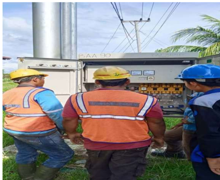
Gambar 2.2 Pengecekan Gardu Distribusi Portal
