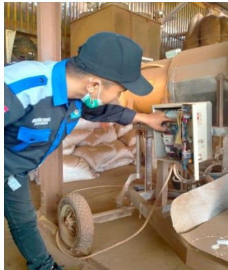
Gambar 2.8.:pengecekan panel kontrol (Sumber :Dokumentasi 2022)
