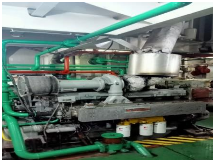
Gambar 2.14 Pengecekan pada mesin utama
