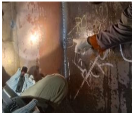
Gambar 2.17 Kebocoran pada joint plat
