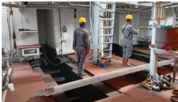
Gambar 3.8 Kondisi engine room sebelum M/E masuk
