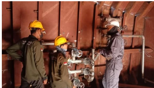
2.21 Pengenalan actual pipe system
