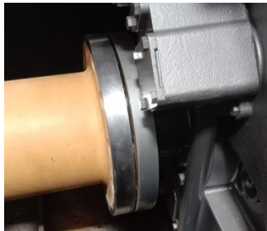
Gambar 3.19 Kondisi kopling sudah dibersihkan
