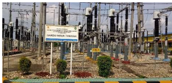
Gambar 1. 2. Gardu Induk PT PJB UBJOM PLTU Tenayan (Sumber: Dokumentasi di PT PJB UBJOM PLTU Tenayan)
