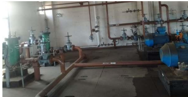
Gambar 2.32. Filter Supply Pump 1 dan 2 PLTU TENAYAN (Sumber: Dokumentasu di PT PJB UBJOM PLTU Tenayan)
