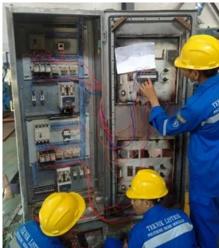
Gambar 2.40. Proses Perangkaian Pada Panel Heater (Sumber: Dokumentasi di PT PJB UBJOM PLTU Tenayan)
