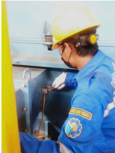
Gambar 3.16 Pengecekan Terminasi Grounding (Sumber:Dokumentasi di PLTU Tenayan)
