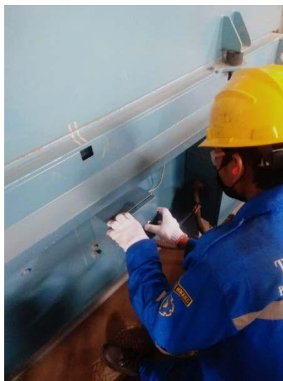
Gambar 3.21 Pemeriksaan Heater Motor (Sumber:Dokumentasi di PLTU Tenayan)
