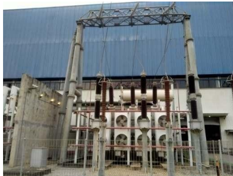
Gambar 2.8. Main Transformer (Sumber: Dokumentasi di PT PJB UBJOM PLTU Tenayan)
