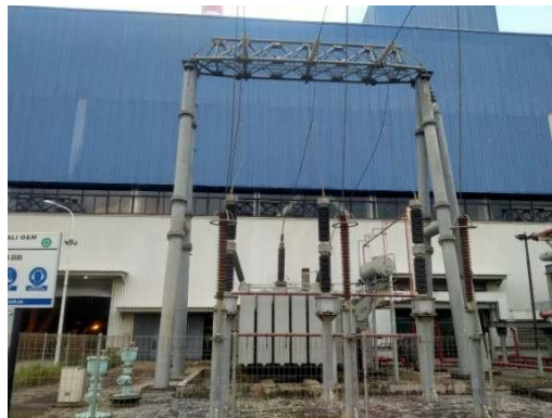
Gambar 2.10. Service Station Transformator (Sumber: Dokumentasi di PT PJB UBJOM PLTU Tenayan)
