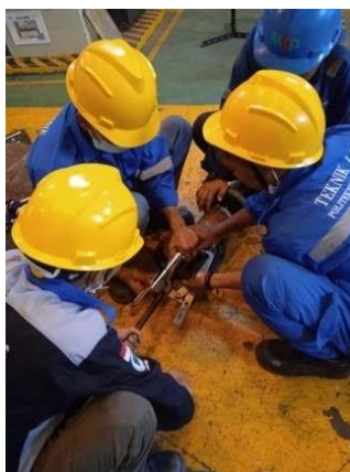
Gambar 2.41. Penggantian Bearing Pada Motor 380 V (Sumber: Dokumentasi di PT PJB UBJOM PLTU Tenayan)
