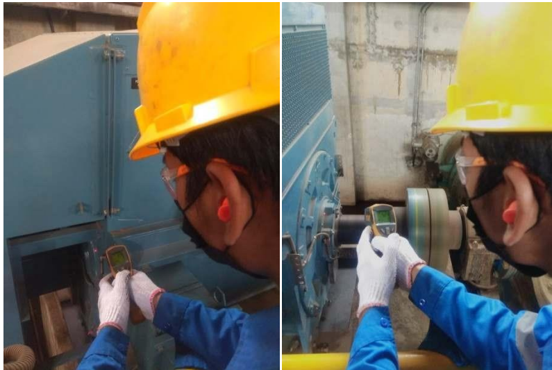
Gambar 3.20 Pemeriksaan Temperatur Motor Bearing DE & NDE (Sumber:Dokumentasi di PLTU Tenayan)
