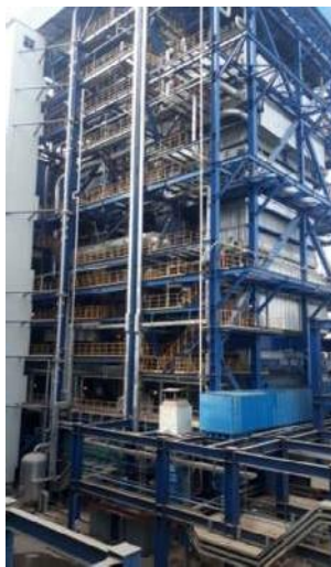
Gambar 2.2. Boiler (Sumber: Dokumentasi di PT PJB UBJOM PLTU Tenayan)
