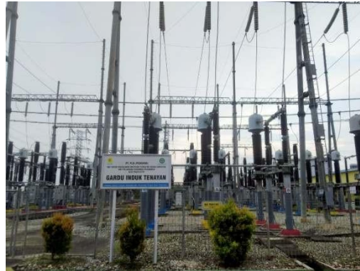
Gambar 2.11. Gardu Induk PT PJB UBJOM PLTU Tenayan (Sumber: Dokumentasi di PT PJB UBJOM PLTU Tenayan)
