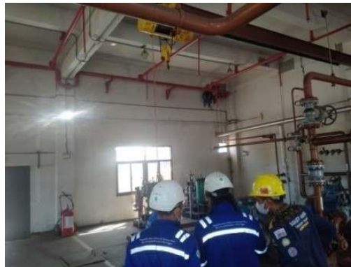
Gambar 2.30. Bagian Dalam Fuel Pump House PLTU Tenayan
