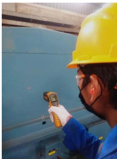
Gambar 3.19 Pemeriksaan Temperatur Motor Winding (Sumber:Dokumentasi di PLTU Tenayan)
