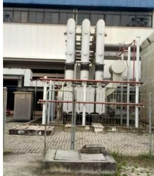
Gambar 2.9. Unit Auxillary Transformator (Sumber: Dokumentasi di PT PJB UBJOM PLTU Tenayan)
