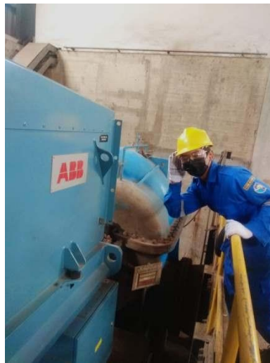
Gambar 3.14 Pemeriksaan Kelainan Suara (Sumber: Dokumentasi di PLTU Tenayan)
