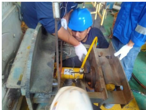
Gambar 2.44. Penanggalan Copling Pada Motor HPFF6 Kv (Sumber: Dokumentasi di PT PJB UBJOM PLTU Tenayan)
