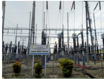
Gambar 2.11. Gardu Induk PT PJB UBJOM PLTU Tenayan
