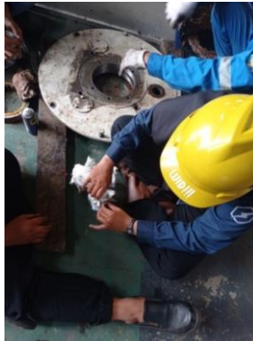
Gambar 2.47. Cleaning Pada Bearing Motor HPFF 6 Kv (Sumber: Dokumentasi di PT PJB UBJOM PLTU Tenayan)
