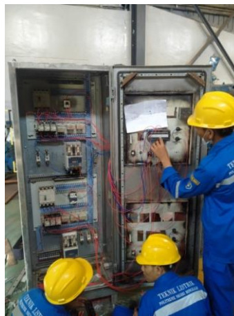
Gambar 2.40. Proses Perangkaian Pada Panel Heater (Sumber: Dokumentasi di PT PJB UBJOM PLTU Tenayan)
