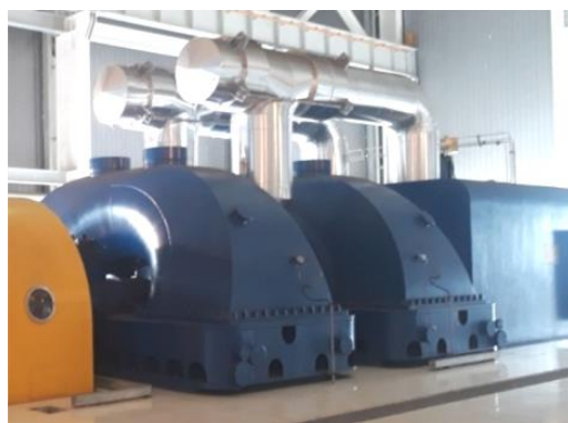
Gambar 2.4. Turbine (Sumber: Dokumentasi di PT PJB UBJOM PLTU Tenayan)
