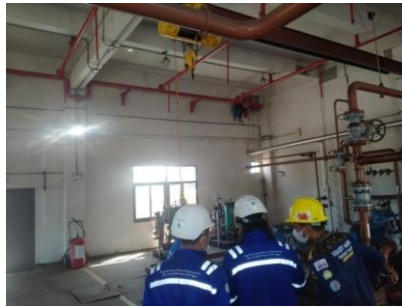
Gambar 2.30. Bagian Dalam Fuel Pump House PLTU Tenayan (Sumber: Dokumentasi di PT PJB UBJOM PLTU Tenayan)
