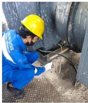
Gambar 3.16. Pemeriksaan Grounding (Sumber: Dokumentasi di PLTU Tenayan)
