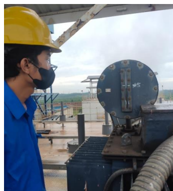
Gambar 3.17. Pemeriksaan Indikasi Kebocoran Dan Level Minyak Pada Trafo ESP (Sumber: Dokumentasi di PLTU Tenayan)
