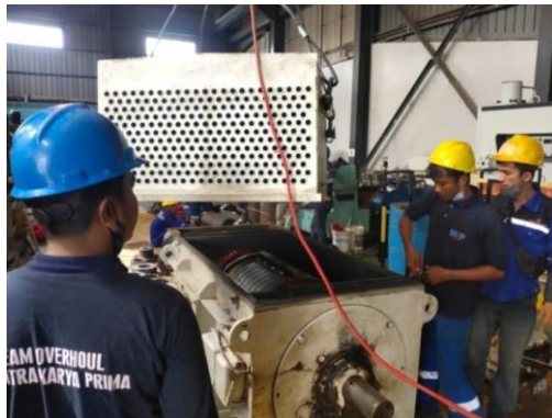
Gambar 2.46. Pelepasan Cooler Pada Motor HPFF 6 Kv (Sumber: Dokumentasi di PT PJB UBJOM PLTU Tenayan)
