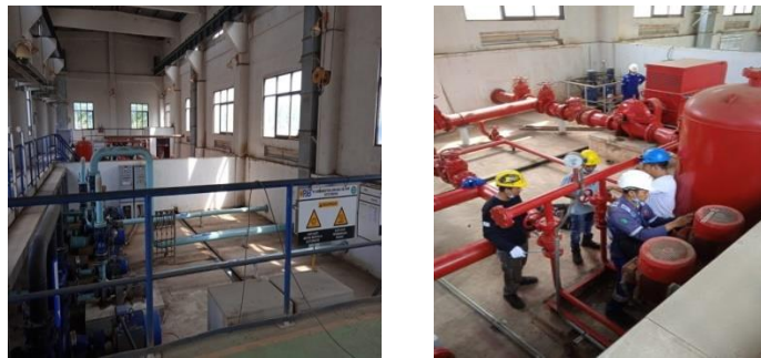
Gambar 2.20. Bagian Dalam Dari Industrial Pump House (Sumber: Dokumentasi di PT PJB UBJOM PLTU Tenayan)
