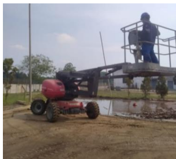
Gambar 2.48. Pemasangan Lampu Jalan 250W Diarea fly ash (Sumber: Dokumentasi di PT PJB UBJOM PLTU Tenayan)
