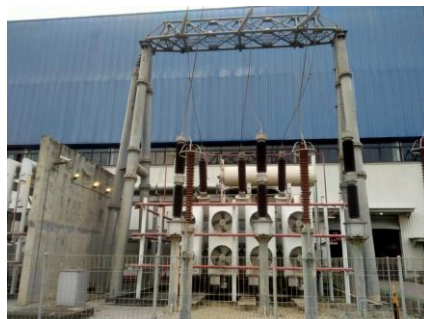
Gambar 2.8. Main Transformator (Sumber: Dokumentasi di PT PJB UBJOM PLTU Tenayan)
