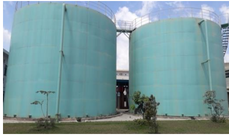
Gambar 2.19. Demin Tank (Sumber: Dokumentasi di PT PJB UBJOM PLTU Tenayan)
