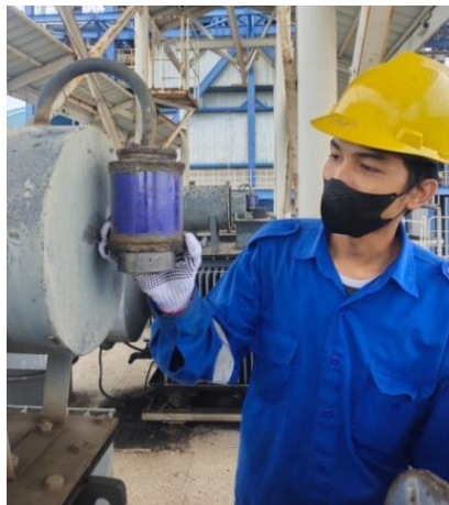
Gambar 3.20. Pemeriksaan Silica Gel (Sumber: Dokumentasi di PLTU Tenayan)
