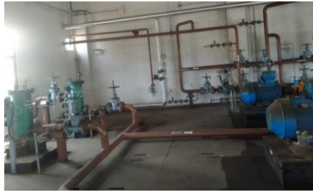
Gambar 2.32. Filter Supply Pump Satu dan Dua PLTU Tenayan (Sumber: Dokumentasi di PT PJB UBJOM PLTU Tenayan)
