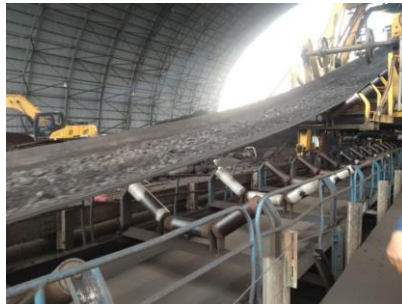
Gambar 2.26. Conveyor C02 (Sumber: Dokumentasi di PT PJB UBJOM PLTU Tenayan)
