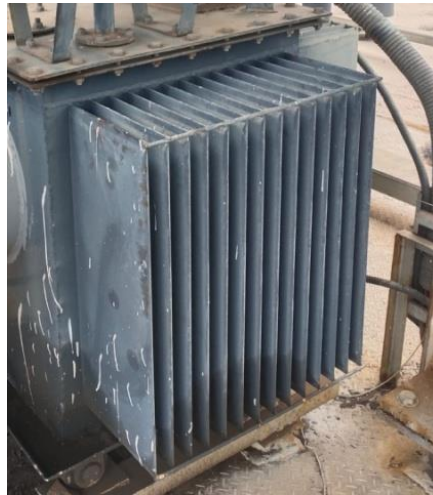
Gambar 3.18. Pemeriksaan Indikasi Kebocoran Radiator
