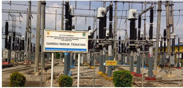
Gambar 1.2. Gardu Induk PT. PJB UBJOM PLTU Tenayan (Sumber: Dokumentasi di PT. PJB UBJOM PLTU Tenayan)
