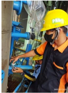
Gambar 2.10 Mengganti Sensor Temperatur (Sumber: Dokumentasi PT. Indah Kiat Pulp & Paper Tbk Perawang, 2022)
