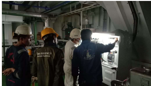
Gambar 2.42 Melakukan Starting Generator
