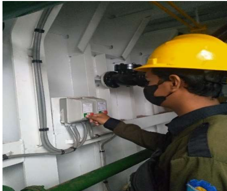
Gambar 3.14 Menghidupkam mesin pompa Ballast
